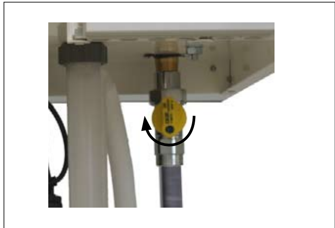
Ilustracja: Przyłącze gazowe Istnieje niebezpieczeństwo zatrucia lub wybuchu na skutek ulatniającego się gazu
