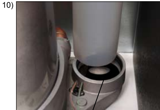
Διάφραγμα στραγγαλισμού καυσαερίων
