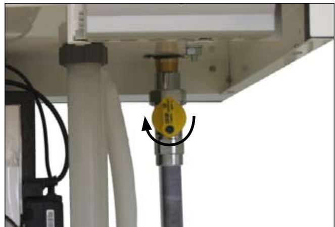
Illustration : Raccord de gaz Danger d'intoxication et d'explosion dû aux émanations de gaz
