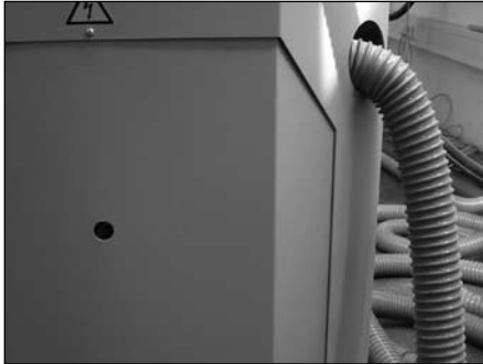
Abb. 42 Durchführung des Rückluftschlauches in der Mitte des Behälters
